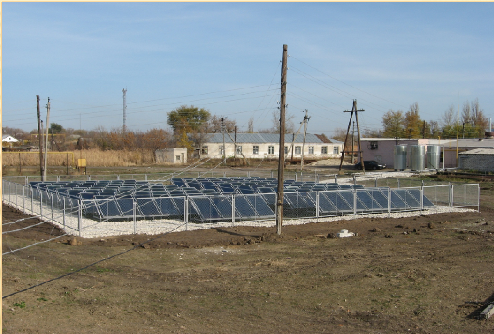
Солнечная водогрейная система введенная в эксплуатацию в Еланской центральной районной больнице
